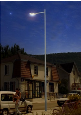
Éclairage pleine puissance
